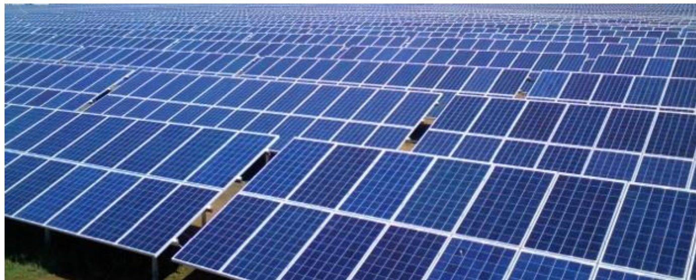
Photo 117 : exemple de tables accueillant des panneaux photovoltaïques
