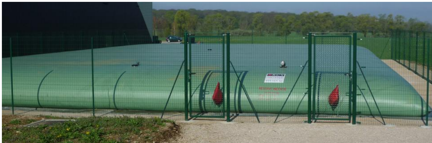
Photo 125 : exemple de citerne à eau pour la lutte incendie
